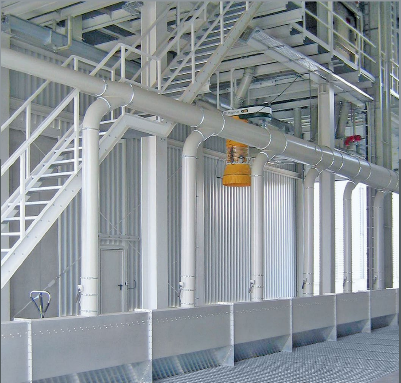
Getreide-Annahmegasse 2,5 x 16 Meter, mit Absaugkaskade und Verbindungsrohrleitung zu einem dezentralen RUBERG-Düsen-schlauchfilter.
